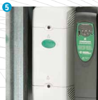
Nuovo quadro VSD
